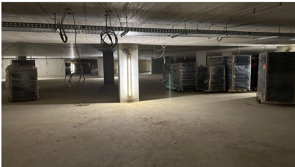
Die Tiefgarage des neuen Schwelmer Rathauses mit 54 Stellplätzen.
