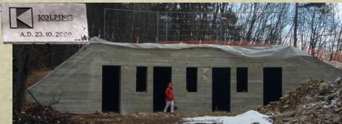
Ab 2009 rollten die Bagger zum Bau eines modernes Küchen- Lager- und Toilettenhauses auf dem Zeltplatz in Graun an. Oben links die Grundsteinplatte, datiert vom 23.10.2009
