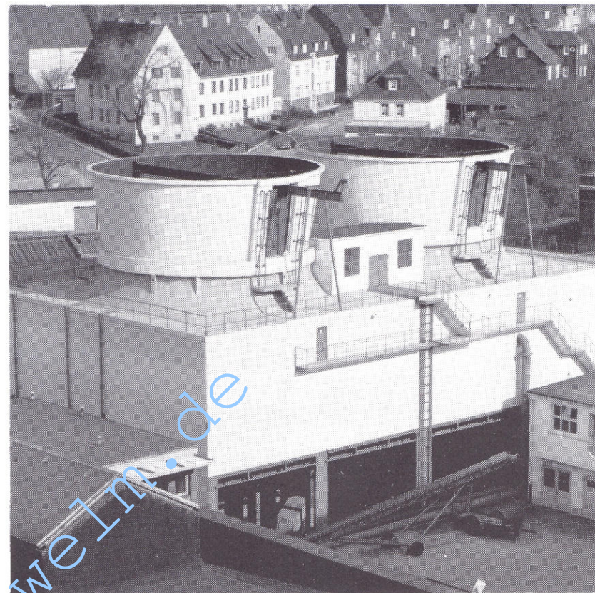
Ventilator-Kühlturm aus zwei Zellen (1959)
