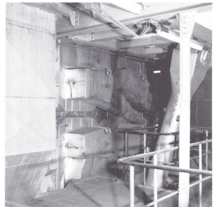
Brennstoff-Zuführung zum Wanderrost (1958)
